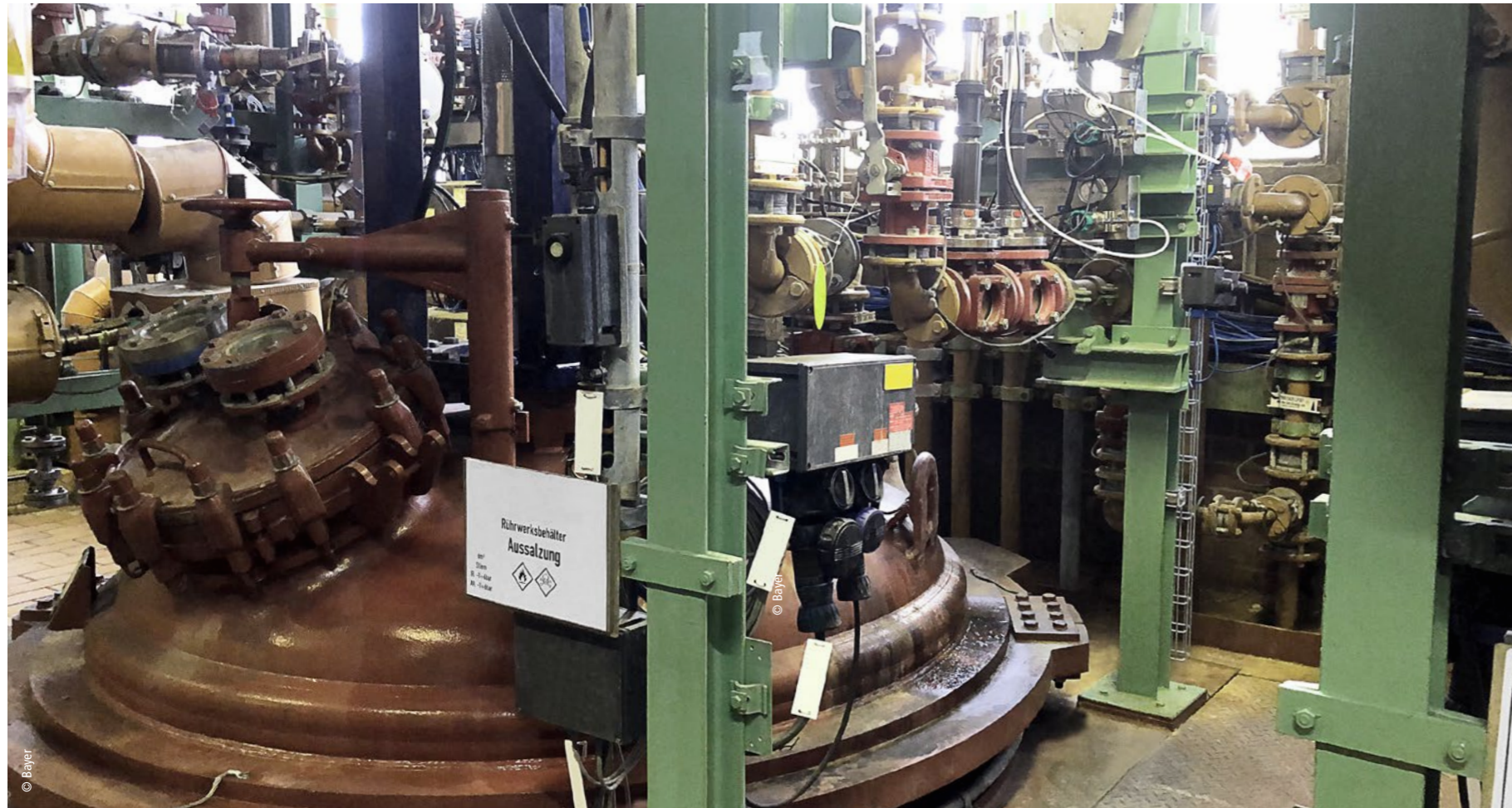
Rührwerksbehälter zur Aussalzung bei Bayer am Standort Dormagen; hier sowie in den anderen Anlagen lässt sich das NOA-Konzept über die hochkompakte Lösung aus Embedded-PC und bedarfsgerecht angereicherten EtherCAT-Klemmen auch bei sehr wenig freiem Bauraum umsetzen.
